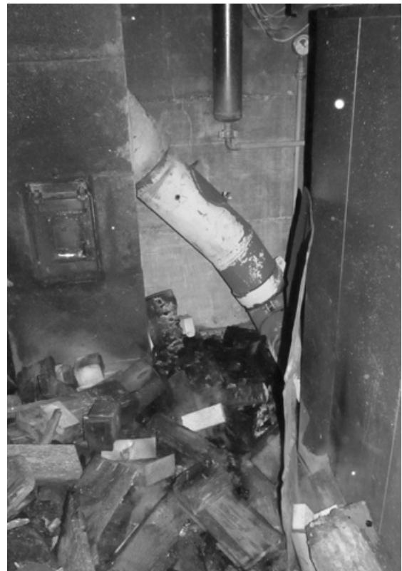
Brand in Heizungsraum Zugerberg 2. Dezember
