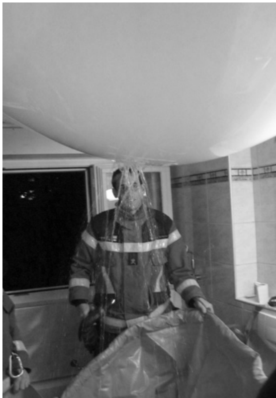
Wasser in Decke Hofstrasse, Zug 12. November
