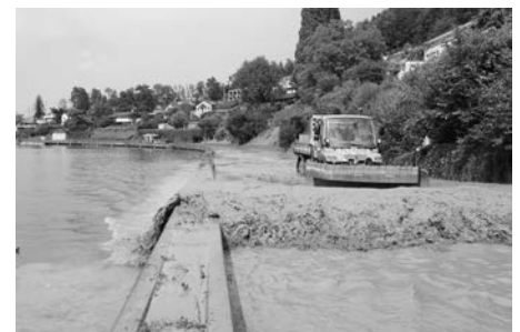
Aufräumarbeiten nach Unwetter.
