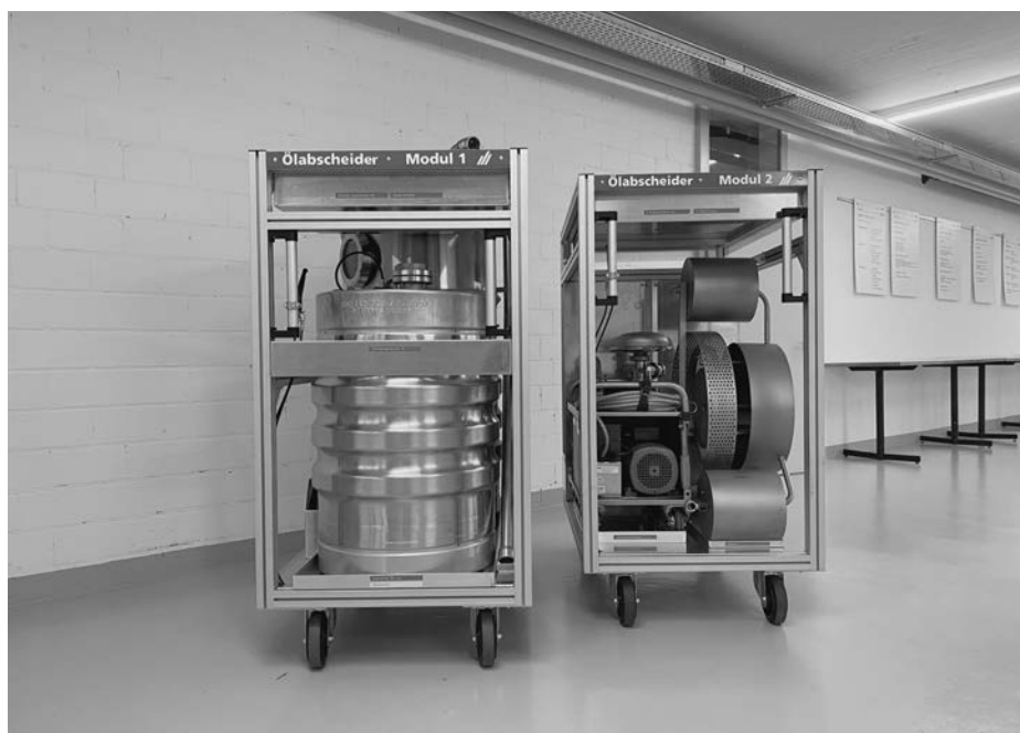
Die beiden Module des neuen Ölabscheidesystems.
